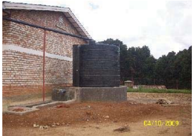
Cisterna da 10 m3
